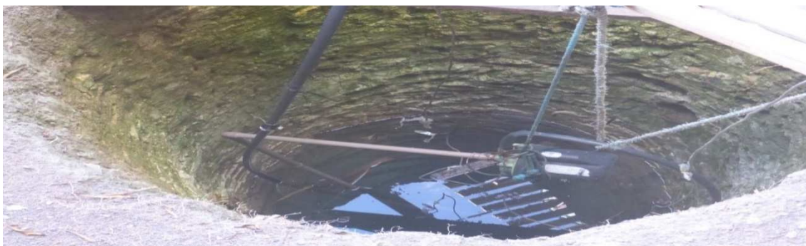
Figura 6 - Poço comunitário com bombeamento
